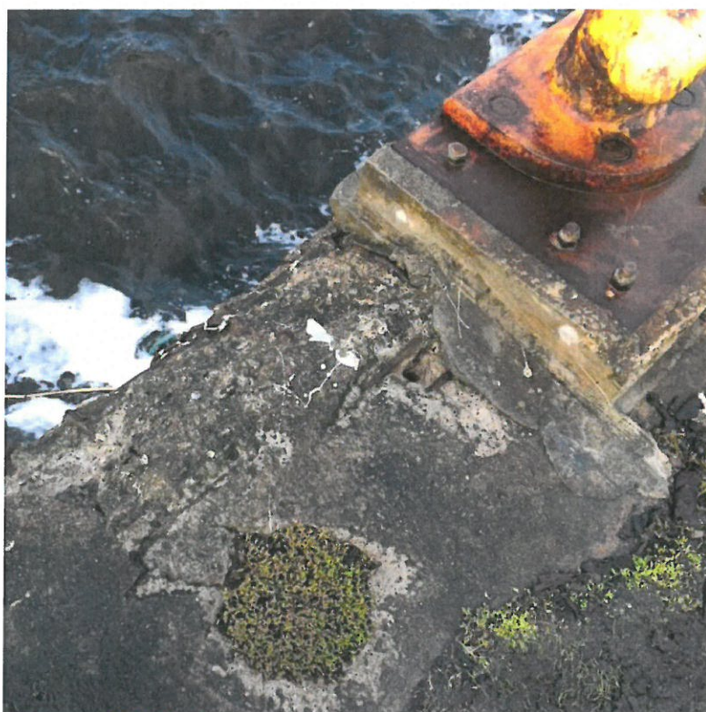
Frilagt armering og usikker innfesting av fortøyningsgods
