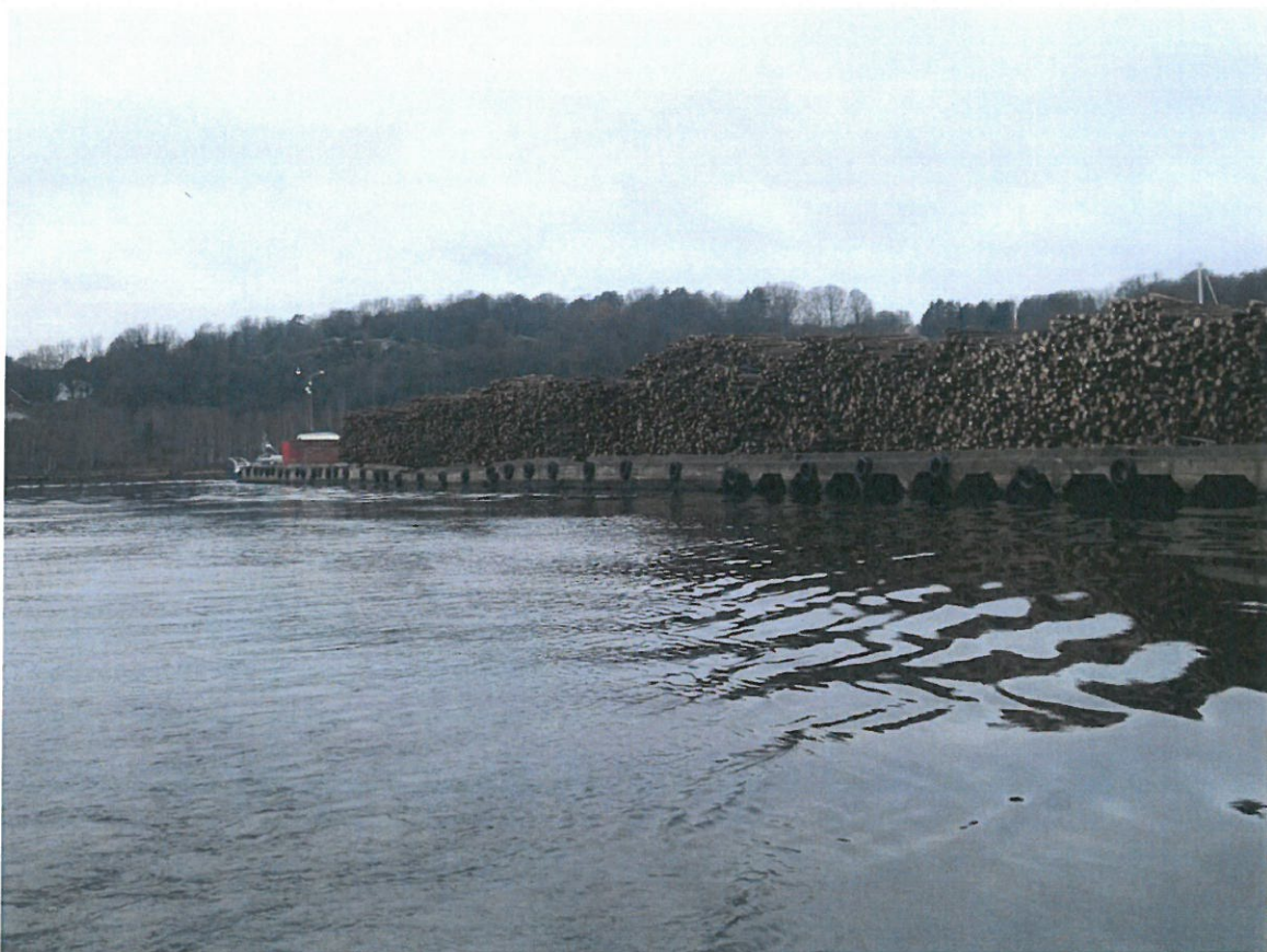
Kaifronten har brudd i betongkonstruksjonen flere steder.
