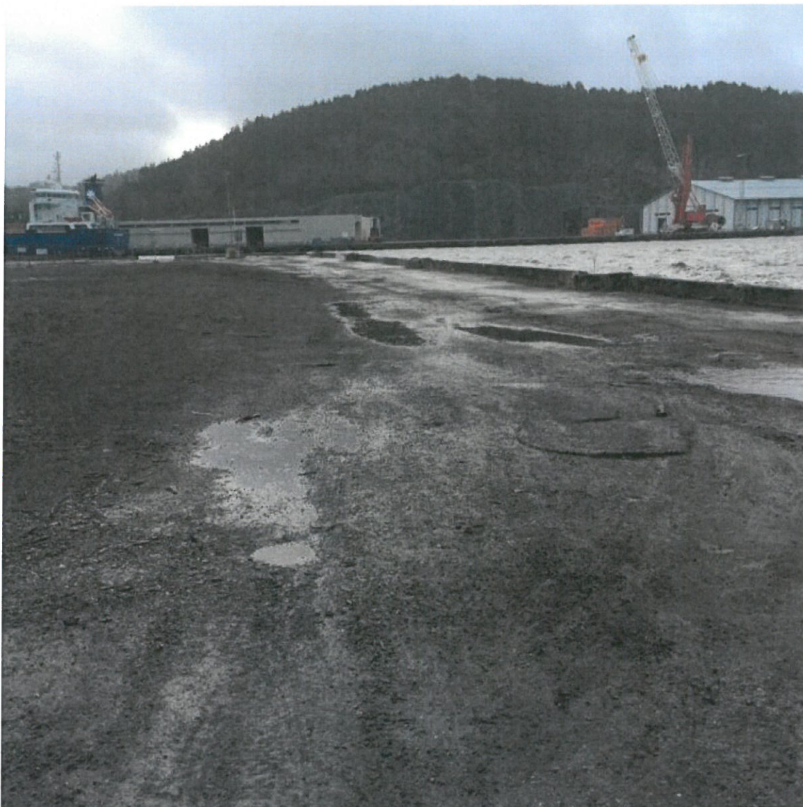
Synlige setningskader med utglidninger i grunnen.
