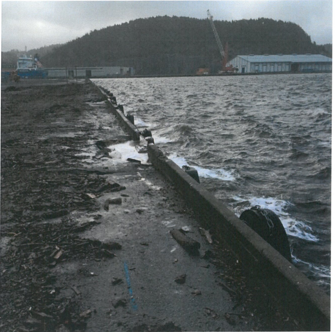
Frontskjørtet i betong er ødelagt og sjøgang gir utvasking under kaien.
