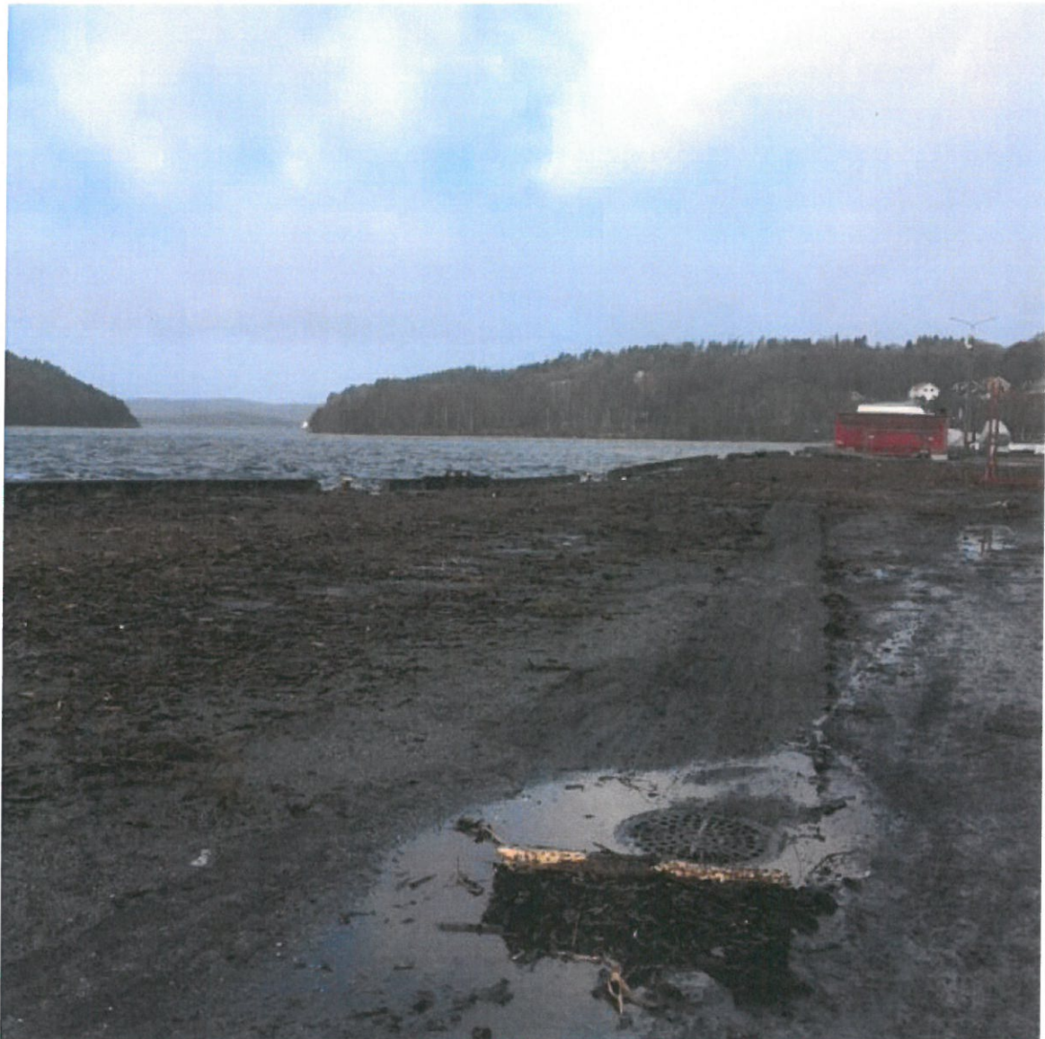
Setninger i terrenget langs kaifront.
