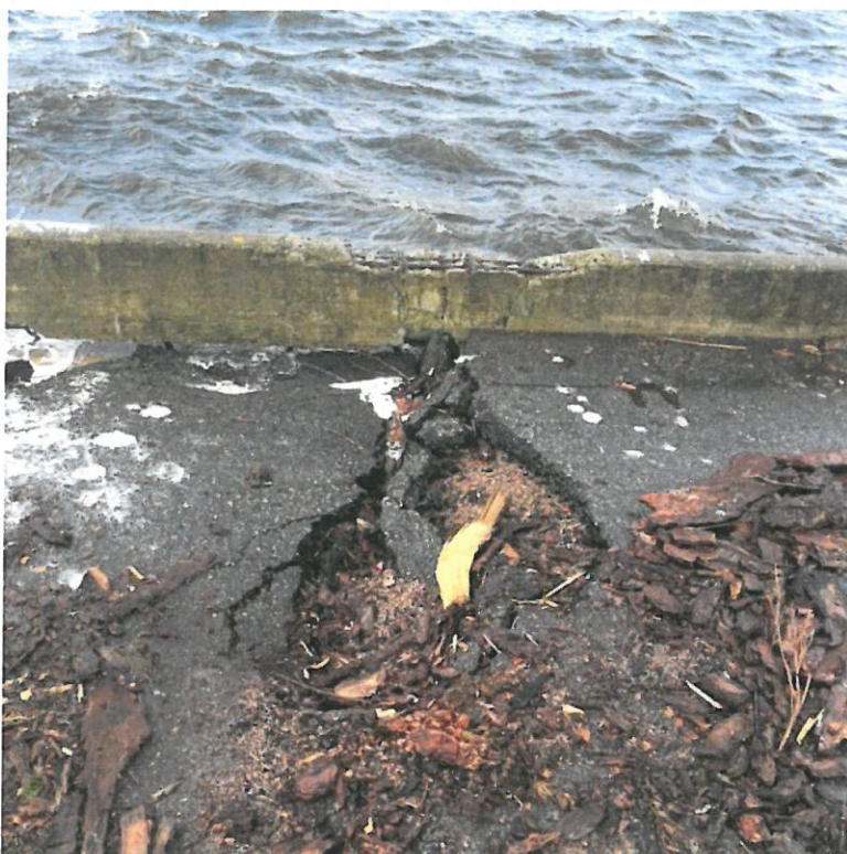
Dårlig kaifront og underliggende utrasing
