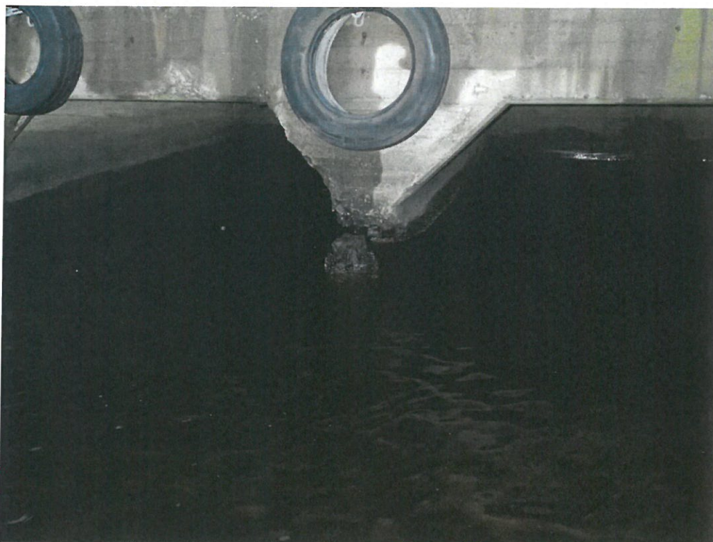
Peletoppene og betong har råtnet/forvitret og er uten sikker bærefunksjon for selve betongkaien i fronten.
