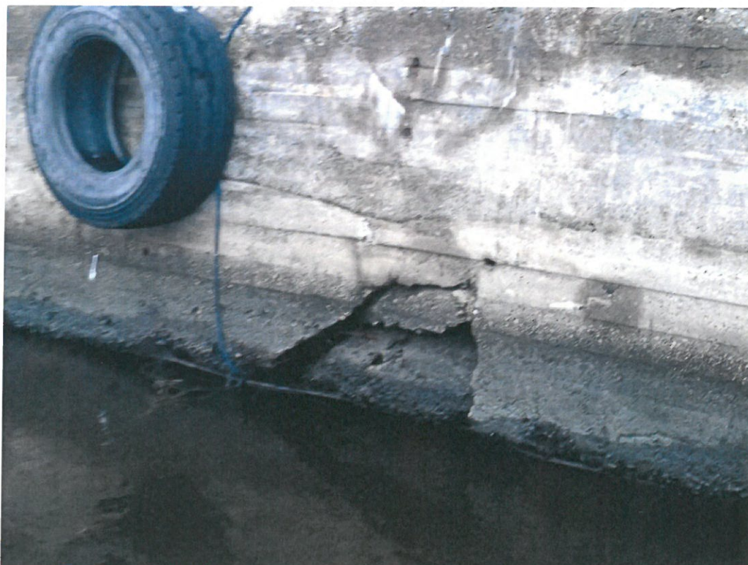
Brudd i betongfront og frilagt armering
