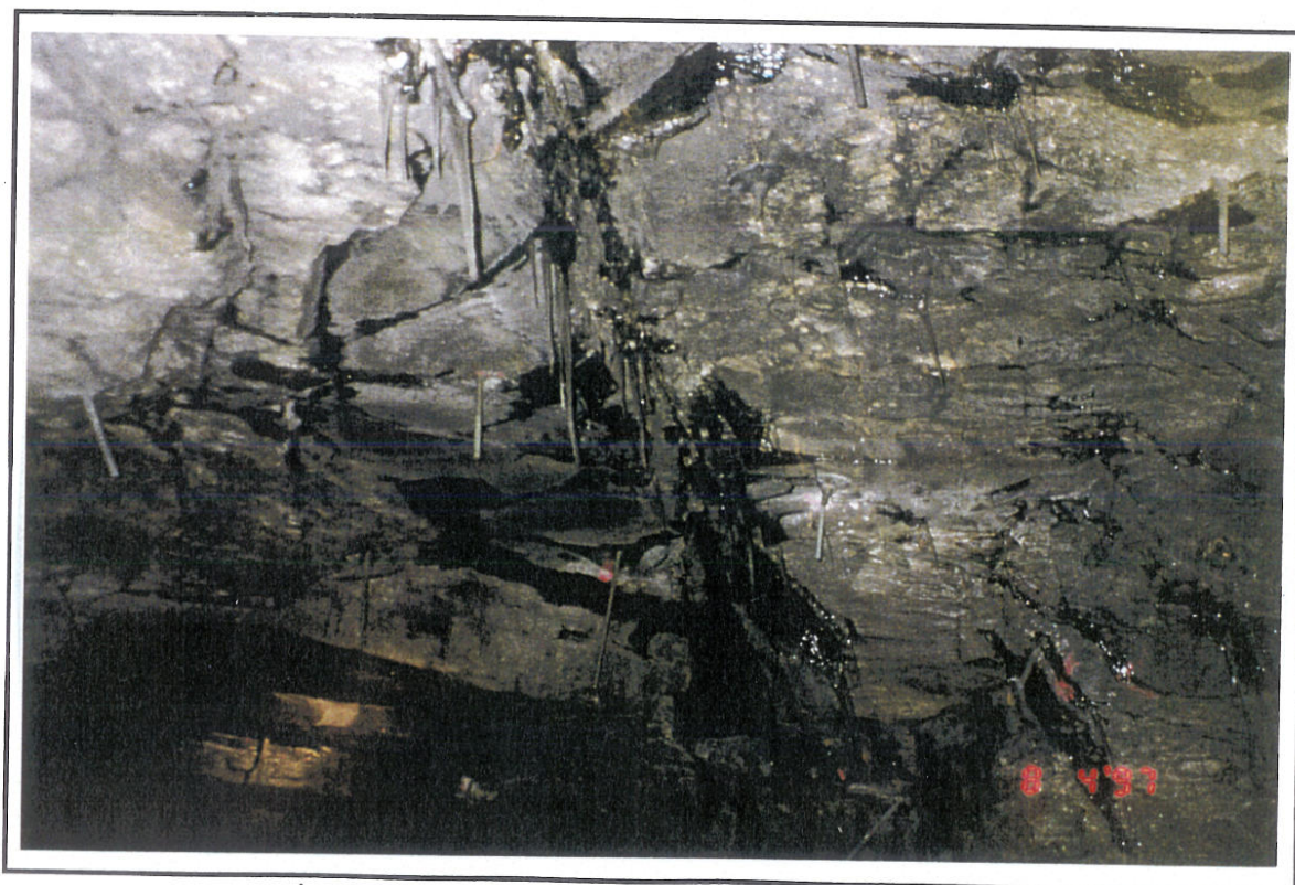
Lunnan tunnel. Vann- og is problemer.
