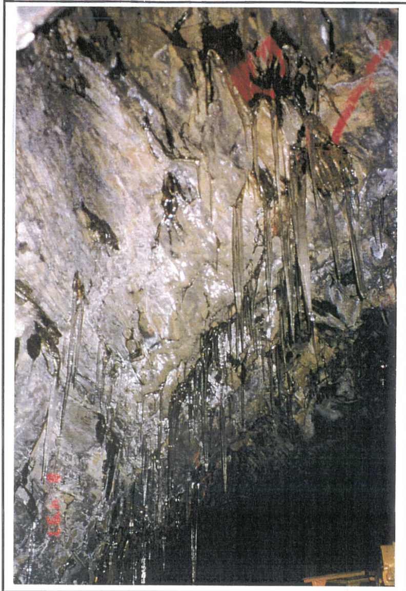
Koabjergen tunnel. Vann- og isproblemer.
