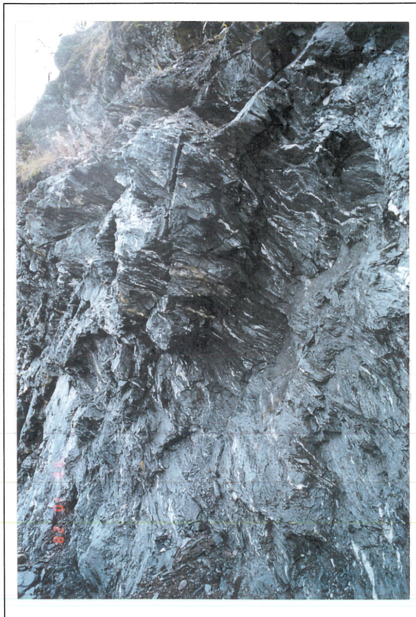
Bilde 3. Ustabilt blokkparti i midtre del av skjæringa indikerer mangelfullt utført sluttrens ved skjæringsutvidelsen.
