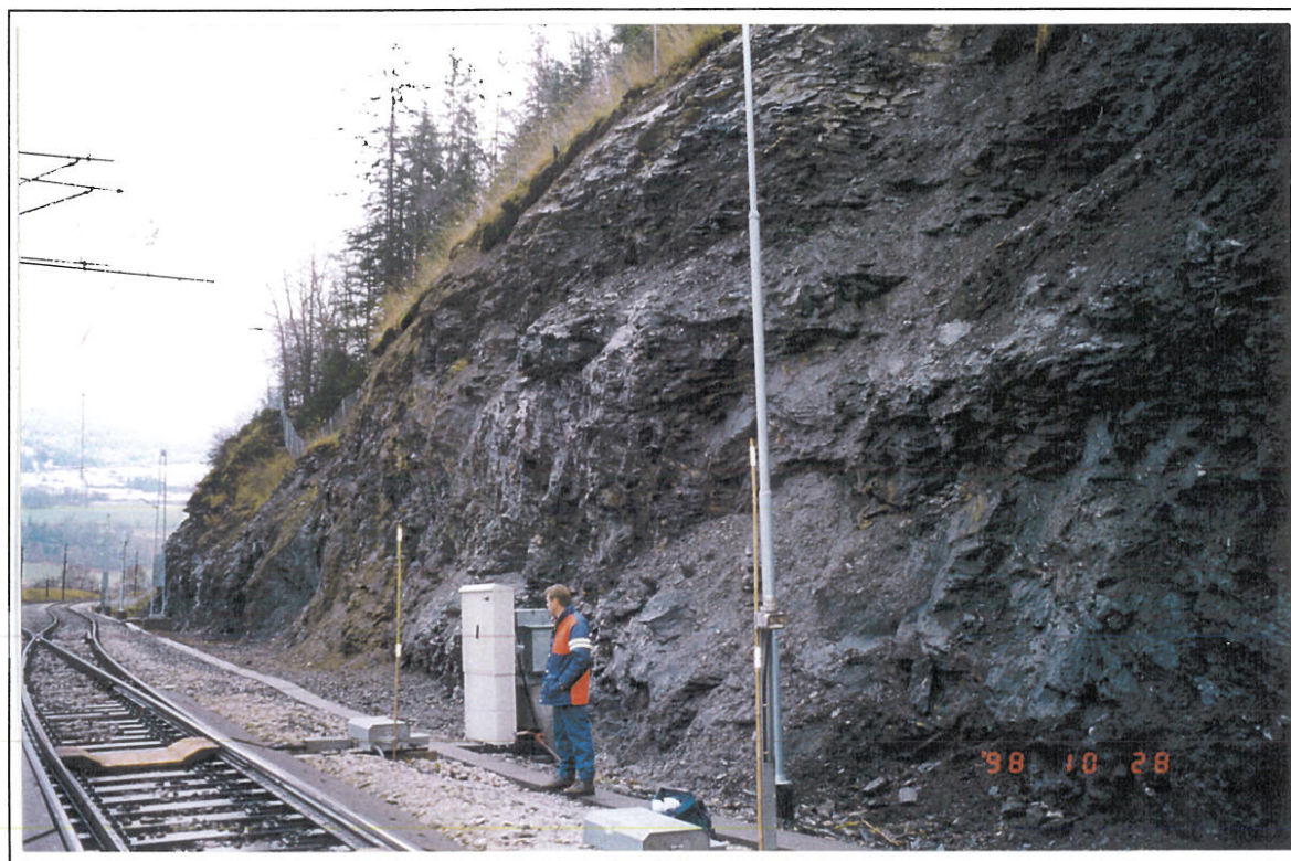
Bilde 1. Mye overflateforvitring i nordre del av skjæringa. Langs dette partiet er fanggrøfta relativt smal, slik at sikringsskap og lysmast kan være utsatt ved eventuelt større nedfall.
