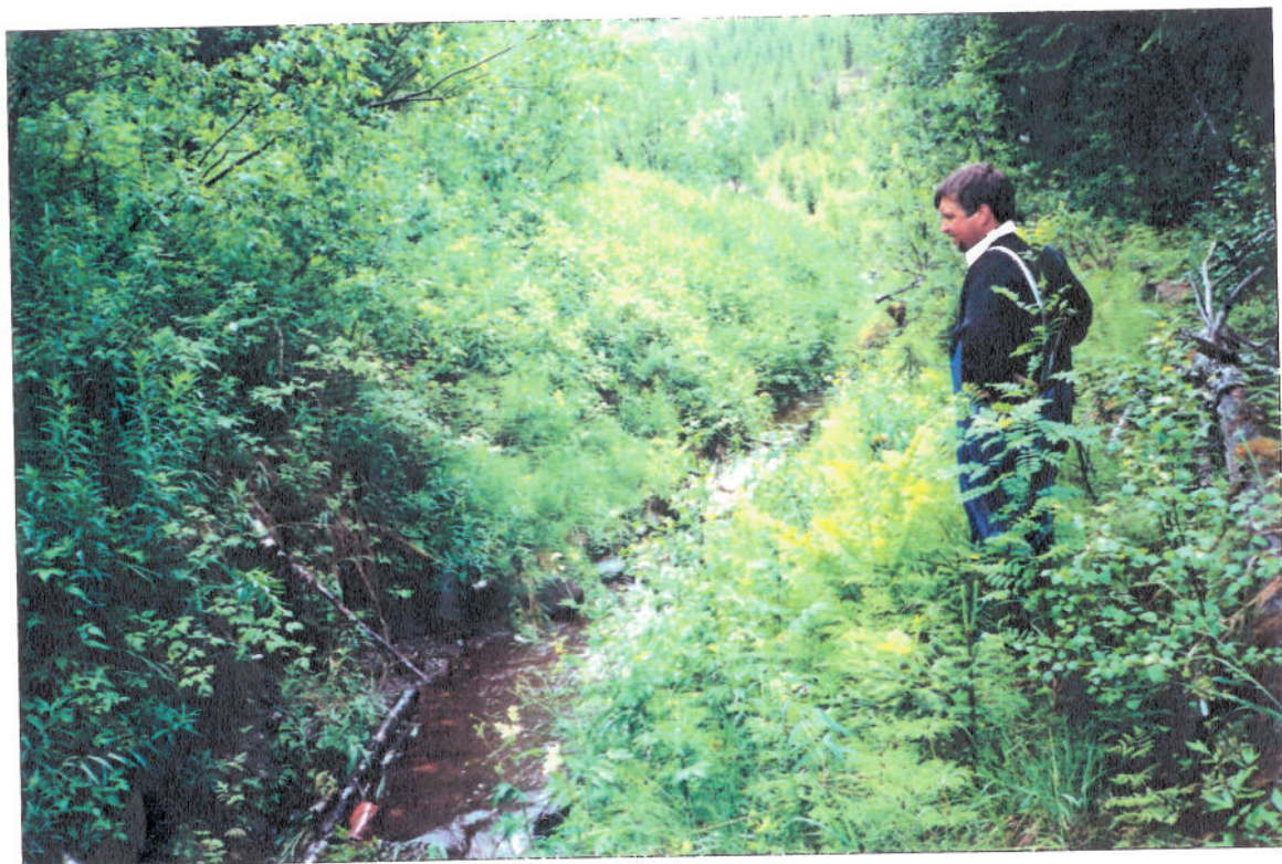
GRØFT VED FYLLINGSFOT. (vestre side) NOE ERUSJON I KANTEN.
